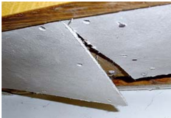
Panneaux légers contenant de l'amiante
